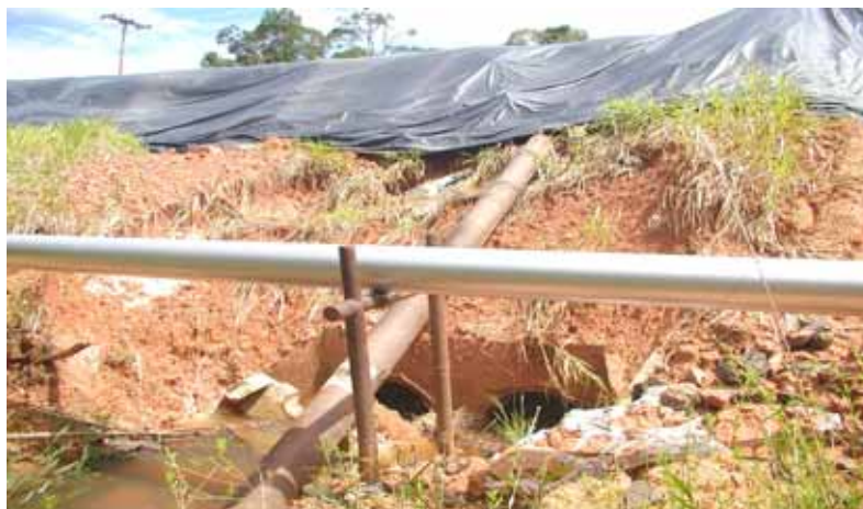
Figura 5 - Observar a falência deste tipo de obra para a canalização de fluxos em estradas. A quantidade de sedimentos que se distribui nas encostas próximas às estradas e às margens dos canais exerce sobrecarga rompendo as caixas de sustentação das manilhas. As lonas sobrepostas no topo auxiliam a retenção de sedimentos nos períodos de concentração pluvial.
