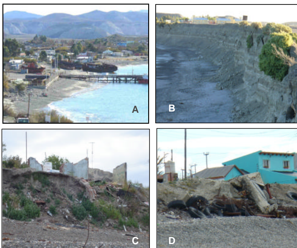
Figura 2: (A) vista general de la costa de Caleta Córdova, (B) detalle del frente litoral con evidencias de erosión activa, (C) resto de casa afectada por retroceso costero, (D) obra de protección costera artesanal (Fuente: elaboración propia)
