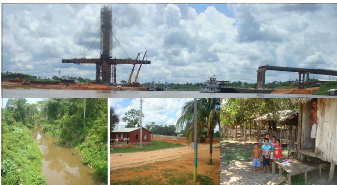
Figura 02 - Monitoramento Ambiental: Construção da Ponte sobre o Rio Juruá e Questões Socioambientais Relacionadas (por BESER DE DEUS, 2010).
