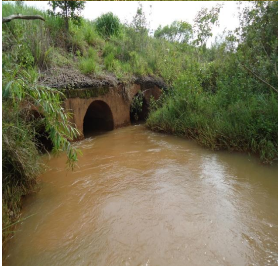
Fig. H: Após o rompimento da rodovia no ano de 2005, uma nova estrutura foi construída na rodovia PR-557 (Fonte: Prefeitura Municipal de Terra Rica, 2007). Fig. I: Obra de contenção em via rural não pavimentada próxima á foz do córrego Trajano (Pesquisa “in loco” , 2010).
