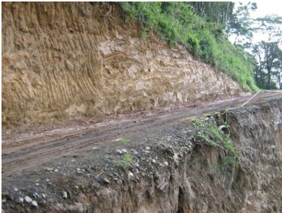
Figura 2. Situación actual de la carretera que comunica Alto Palomo con Bajos del Toro. Dicho sector se localiza dentro del área de fragilidad ambiental muy alta. Debido a la inestabilidad del terreno y las altas pendientes de este sector la convierten en una zona de alto riesgo.
