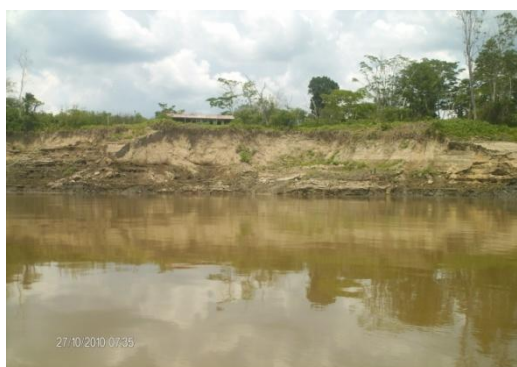
Figura 04- Escola Municipal ameaçada pelas terras caídas.
