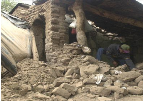
Imagen Nº 2: Una de las viejas casas, hecha de adobe, se desplomó durante el sismo. S. F. del Valle de Catamarca. Fuente: Diario C
