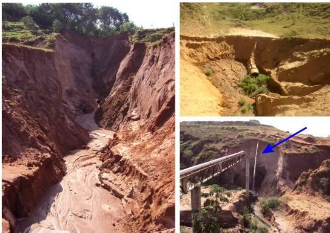
Fig. 5a: Ruptura de galeria pluvial com formação de amplo ravinamento; 5b: Galeria pluvial danificada, com conseqüente retomada da erosão; 5c: Subsidência de fundação provocando ruptura de rede de esgoto (indicada na seta).
