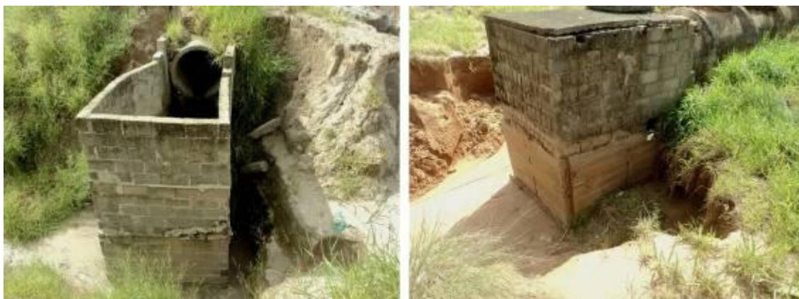
Fig. 6a e 6b – Dissipadores de energia apresentando-se exumados pela erosão de borda
