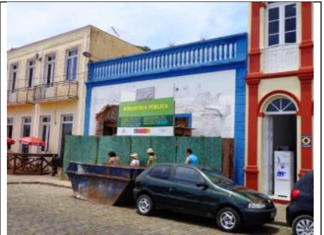
Foto 12. Edifício em processo de recuperação para instalação da Biblioteca Pública (foto do autor – 11/2014)
