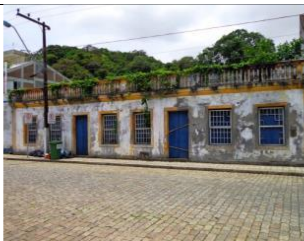
Foto 14. Edifício abandonado (foto do autor – 11/2014)
