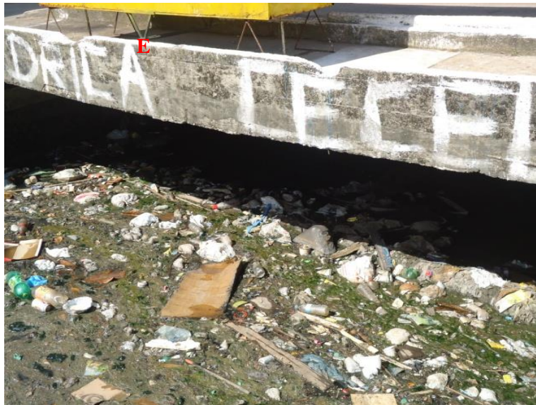
Figura 04- Trecho da área da Baixada do Bairro do Marco: (A) Disposição das casas; (B) Falta de drenagem para as chuvas e consequências; (C) Canal Principal da Rua José Leal Martins com depósito de lixo em suas margens; (D) Barragem de Areia e Barro para impedir o transbordamento das águas do canal atinjam as residências; (E) Lixo no canal José Leal Martins. Elaborado por SANTOS, O. C. de O. (2015).
