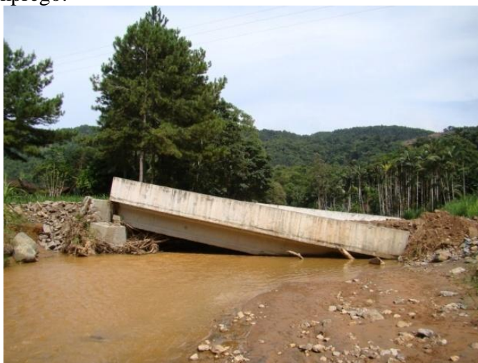
Figura 3 Ponte destruída pelas chuvas ocorridas em janeiro de 2011. Estrada Geral do Baú (1). Autor(a): Lisangela Albino (2011)
