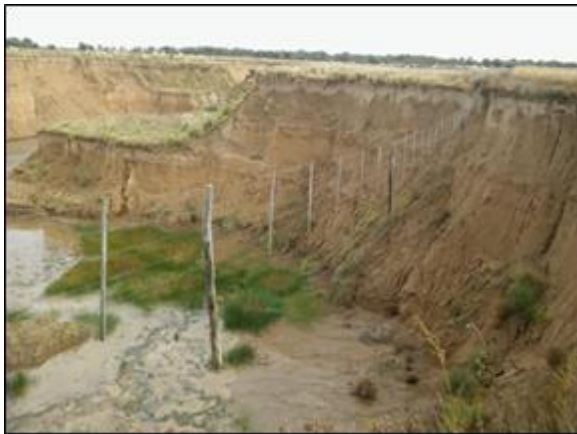
e. Colapso de túneles (piping / sapping)
